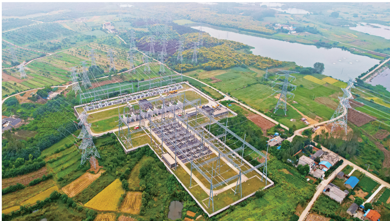
500千伏龙门变电站航拍
