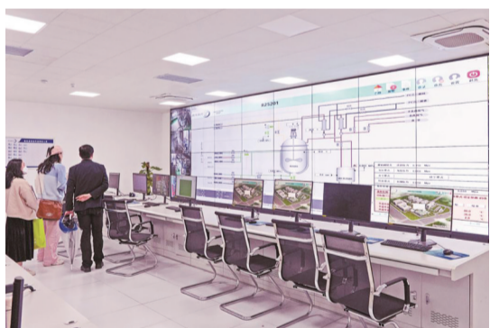
皓元医药马鞍山产业化基地中心控制室
