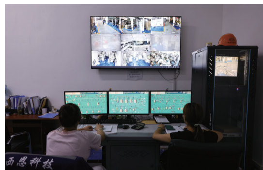
企业生产车间内的中控室
