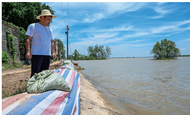
宿松县洲头乡刘小圩,防汛人员在检查与江水几乎齐平的外圩临时堤坝
