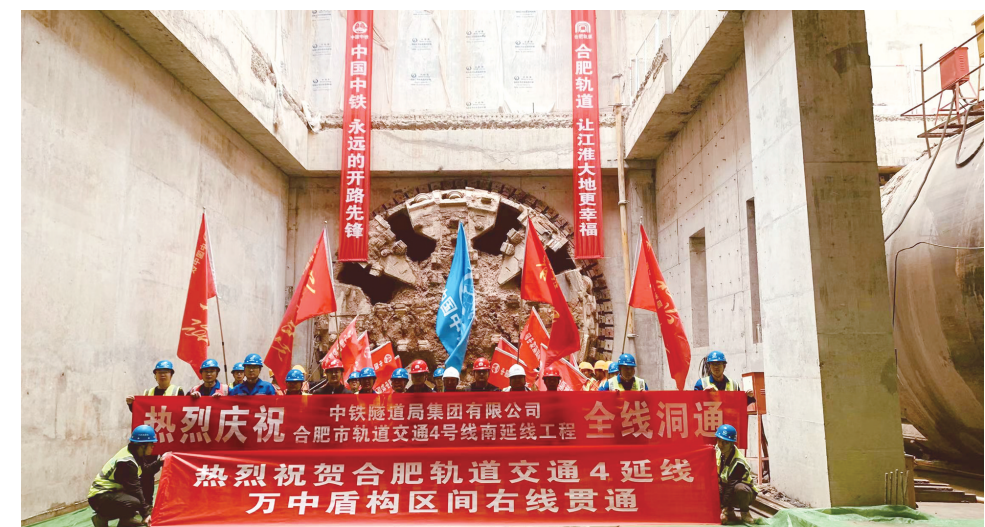
3月7日,记者从合肥市轨道集团获悉,轨道4号线南延线万佛山路站至中间风井区间右线顺利贯通,标志着4号线南延线顺利“洞通”,为合肥轨道三期建设项目中首条实现“洞通”的线路。4号线南延线全长13.97千米,线路起于金桥路站,是串联起高新区和肥西县的重要线路。 记者 王珊珊
