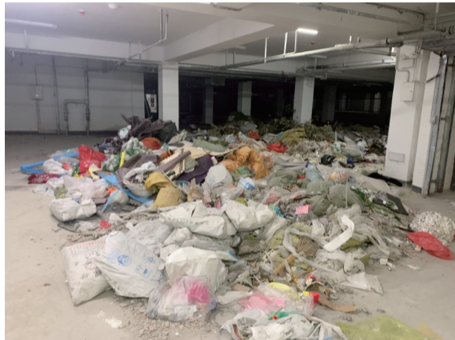
地下车库负二层堆放着垃圾
