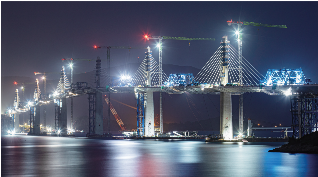
2021年6月22日在克罗地亚南部的科马尔纳村附近拍摄的佩列沙茨大桥施工现场。(资料图) ■ 新华社发 耶拉维奇/摄
