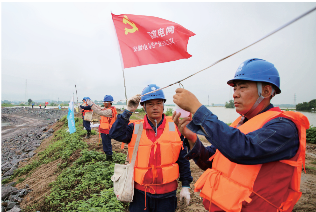
忠旗服务队队员们坚守在庐江县同大镇的大坝上,安装防汛所需的电力线路和照明设施
