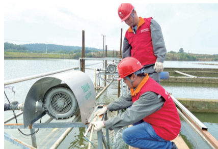
肥西县供电公司员工上门为紫蓬镇扶贫产业园进行安全供电检查 田俊伟/摄
