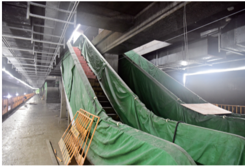
4号线天鹅湖站内电梯已经安装
