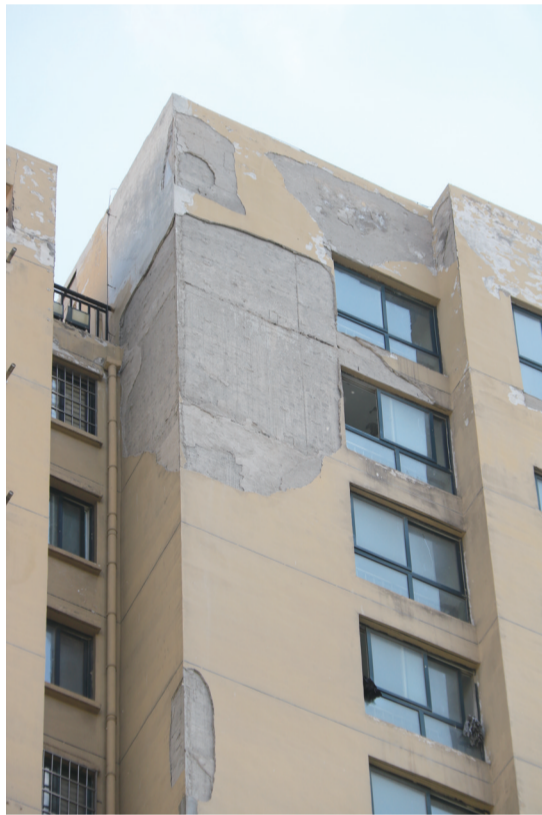
掉落后的外墙面
