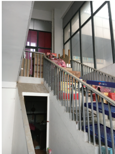
琳琅街内,一处消防通道楼梯堆满了货物
