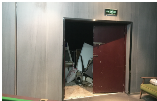
写字楼A座,安全通道内堆放着各种杂物
