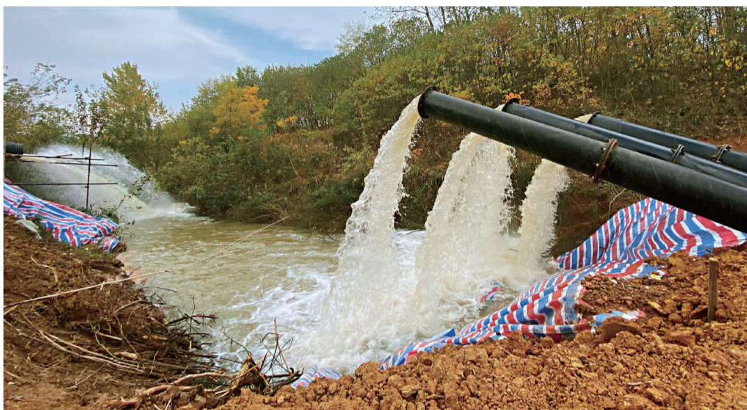
全椒县水利局架设临时泵站，通过滁河小罗闸将长江水源源源不断送往赵店水库，为市县自来水厂储备源水
