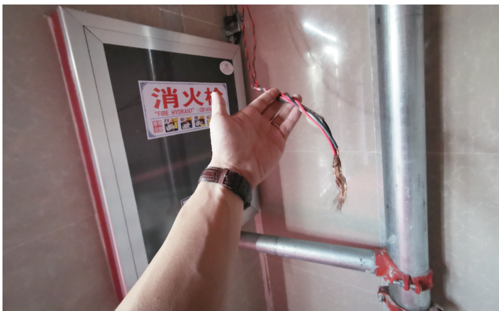
一楼大厅电线裸露在外 图片来源: 988置业有声
