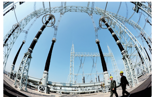
国家电网安徽检修公司职工对淮南——上海1000千伏特高压淮南变电站运行设备进行巡查
