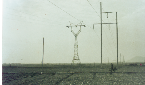
1956年安徽省内第一条110千伏输电线路—佛子岭-六安-合肥线路的建成投运
