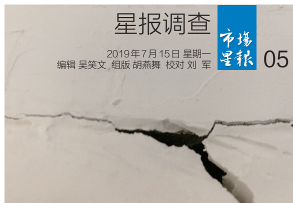
房间门框上方出现裂缝
