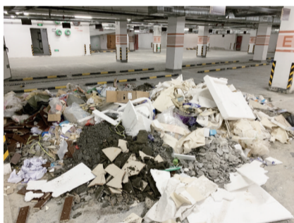
小区地下车库内堆放的建筑垃圾
