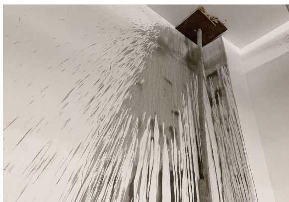
地下车库墙面上有污水漏出的痕迹
