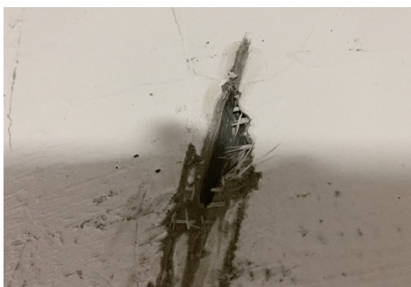
地下车库房梁白色的粉刷层发现里面是用来加固的钢板
