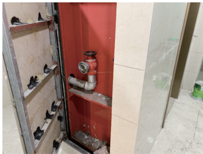
已交付的6号楼内消防设备缺失
