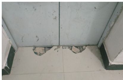
电梯门口的破损
