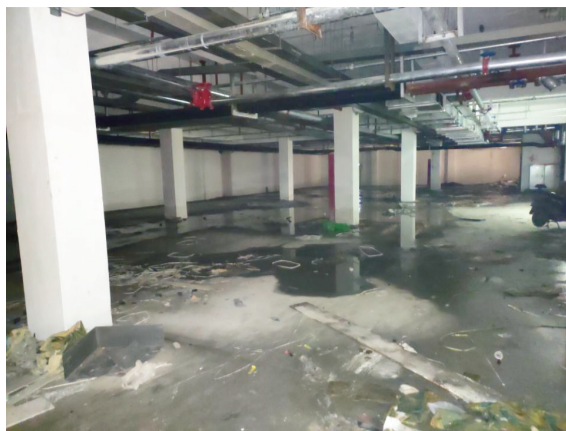
地下车库的积水
