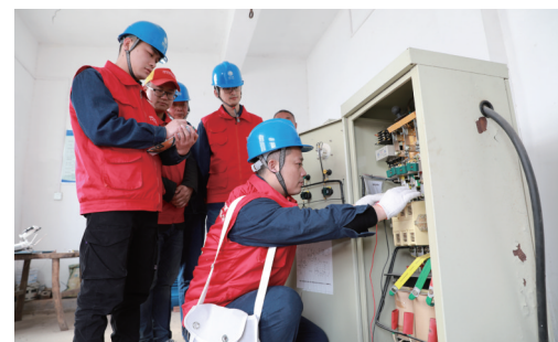
随着春耕工作的开始,为了保证各乡镇排灌站在春耕排灌期间的安全可靠供电,近日,安徽淮南潘集供电公司党员服务队组织队员深入到辖区内各抽水排灌站,开展排灌设备的安全用电检查工作。 □张军 王银 吴传贤
