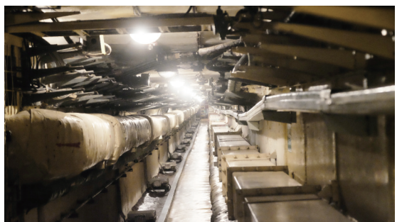
连接地下指挥单元和地面的隧道
