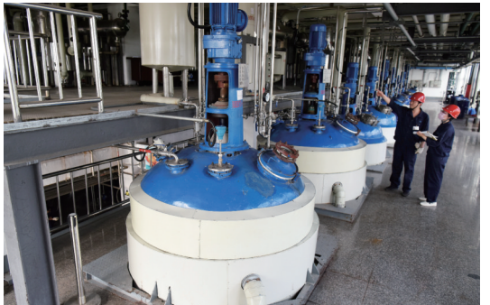
安徽贝克联合制药有限公司生产车间内工作人员正在检查设备运行情况
