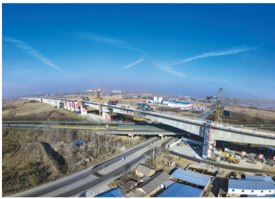
12月8日,由中铁上海工程局三公司承建施工的商合杭铁路站前11标控制性工程——跨淮蚌高速公路特大桥梁128米连续梁顺利合龙。商合杭铁路站前11标位于淮南市、长丰县境内,正线长度39.434公里,计行车速度350km/h,合同中标总价25.21亿元。
