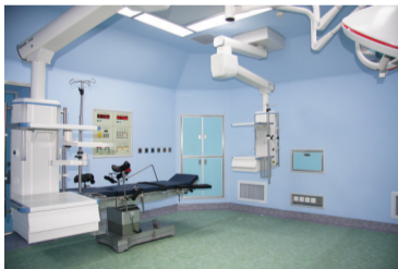
净化层流手术室
