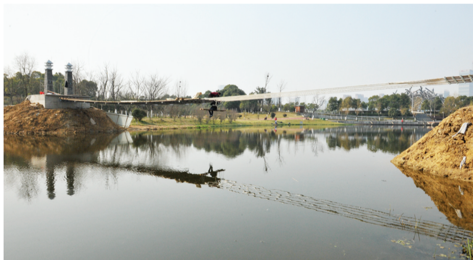
合肥滨湖新区塘西河上新建铁索桥。目前,正在进行桥面铺设,上半年可竣工。铁索桥建成后,不仅方便市民游览河对岸美景,也为塘西河增添一道新的风景线。 ■倪路/图
