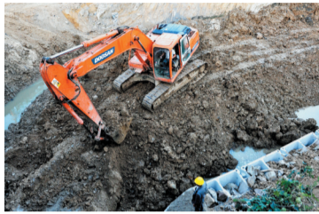
合肥十五里河上游综合治理工程全面展开,现正进行河道清淤、护岸的加固。治理工程起自天鹅湖,终点为312国道,长约5.15公里,涉及清淤、绿化、护坡护岸、拦水堰、涵洞加固、草皮护坡、新建生态挡墙等。
