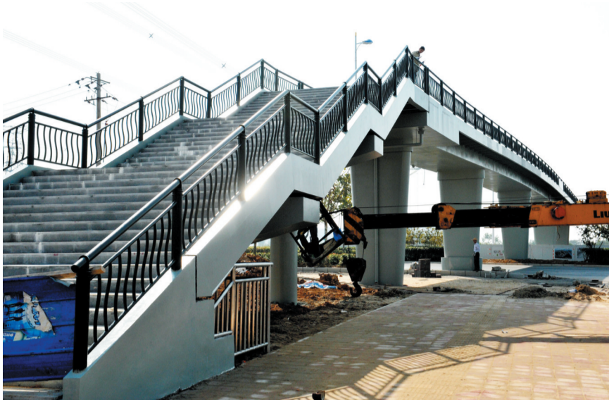
合肥七中新校区门口新建人行过街天桥进入收尾阶段,近期即可通行。该天桥主桥宽5米,长度约70.1米,南北跨越望江西路,采用连续钢箱梁结构形式。 记者 倪路/摄
