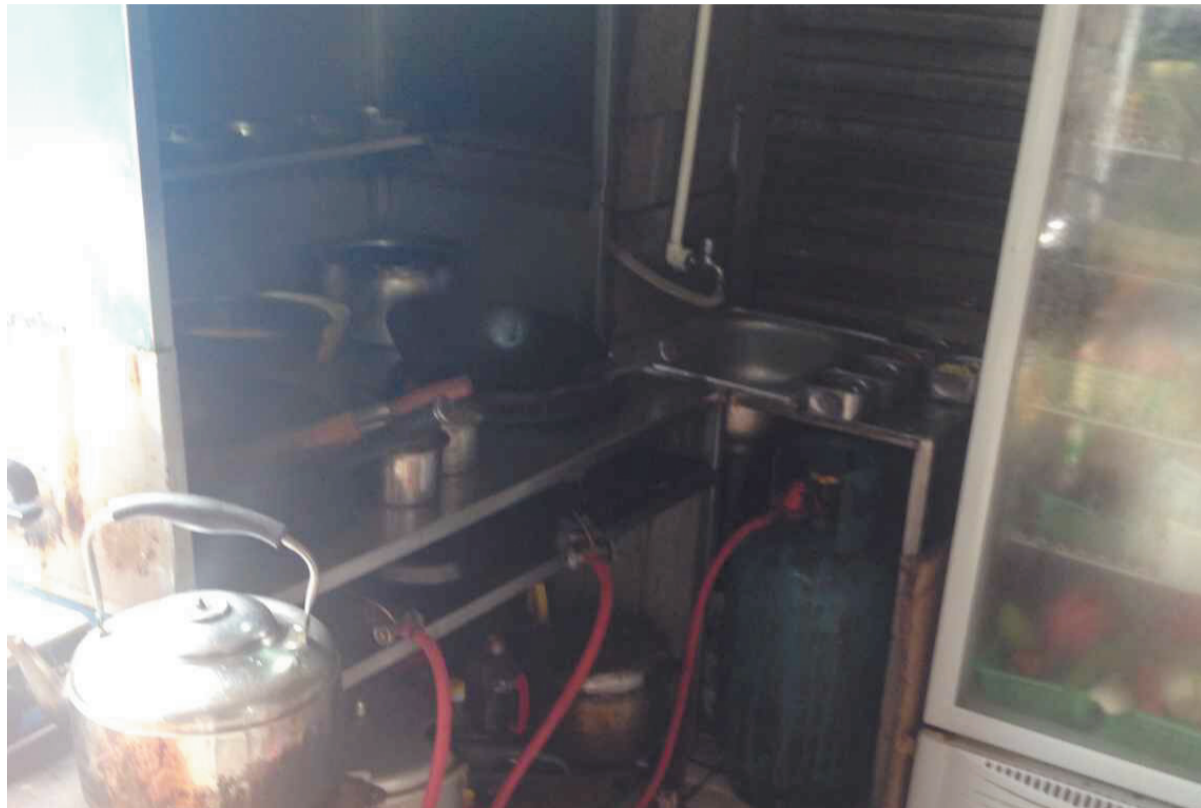
油烟管道污垢很严重
