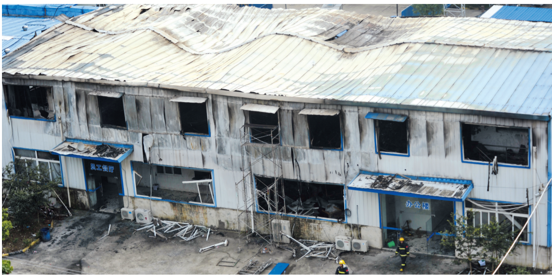
火灾后严重受损的二层楼房
