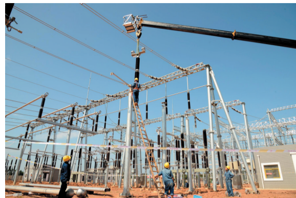
昨日,宣城户外温度已连续多日保持在36摄氏度以上,而广德500千伏变电站内建设正酣,近百名电网建设者正冒着酷暑,加紧建设宣城电网的第三座500千伏变电站。广德500千伏变电站是华东电网公司在皖重点投资项目,系我省第4座500千伏智能变电站。孔超 杨媛媛 记者 曹开发 文/图
