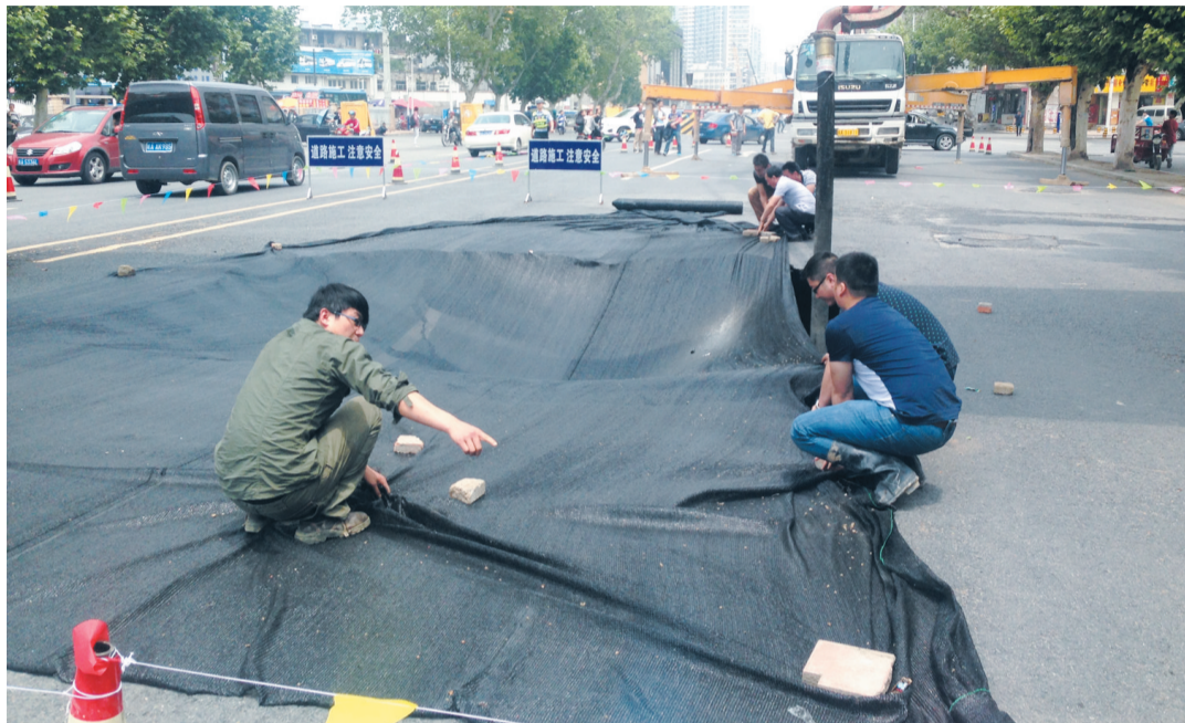
塌陷后没多久，现场就铺设起了黑布
