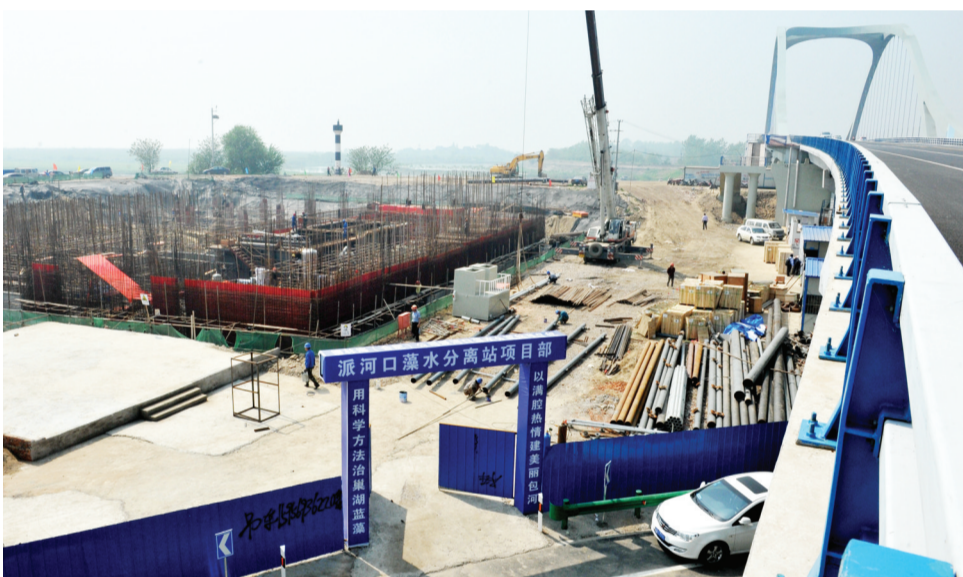
为了进一步控制巢湖蓝藻、净化巢湖水质,合肥市投资1亿元,开建第二座藻水分离港。派河口藻水分离港,主要是控制万达文旅城、派河口为重点约6公里岸线区域,规模与塘西河藻水分离港相当,总施工期约10个月。 记者 倪路/图
