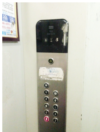
电梯维修服务电话按钮模糊不清
