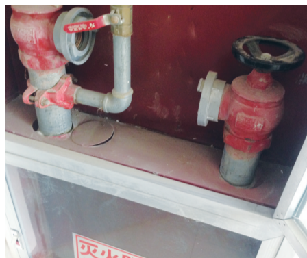
消防队员迅速打开楼道内的消防栓,没想到的是消防栓内竟然没有一滴水
