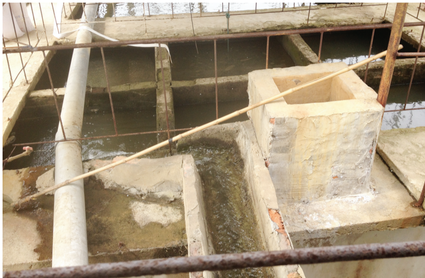
浮山自来水厂生产现场
