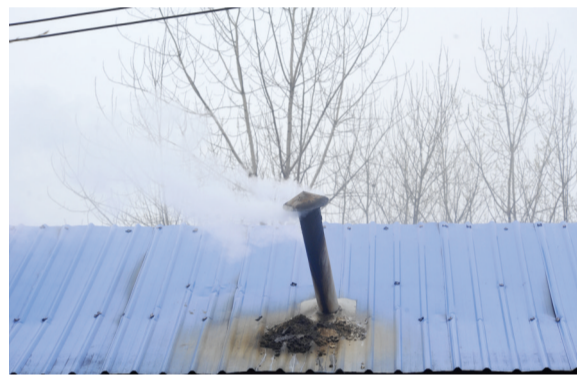
▲废气直接排出
