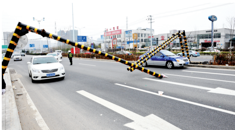
昨日上午,记者看到,合肥西二环上跨望江路桥南头的限高架被大货车撞坏,整个限高架断成两截横在路上,由南向北的车辆只能从断架下缓慢通过。 记者 倪路/图
