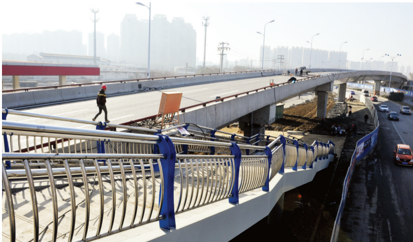
在合肥畅通二环工程集贤路节点施工现场,上跨西二环的互通立交桥已经完工。
