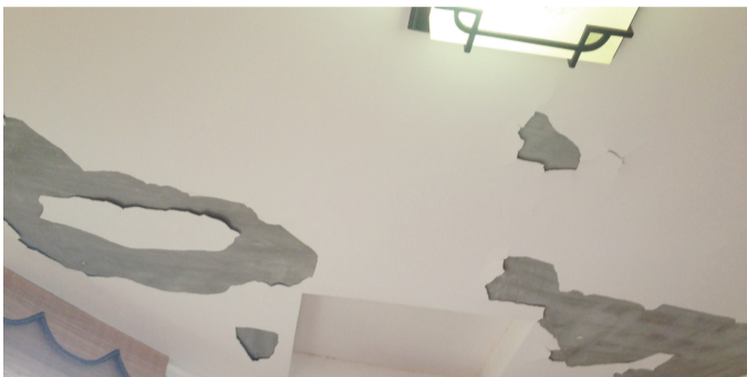
房顶大面积脱落
