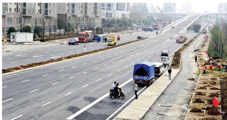
日前,合肥高铁南站片区高铁路路面铺设完成,现正在进行隔离带及路旁绿化施工。高铁路工程(屏山路至徽州大道,庐州大道至包河大道)全长2.2公里,路幅40米,南北高架与高铁路相连,可直达高铁南站候车厅。 记者 倪路/图
