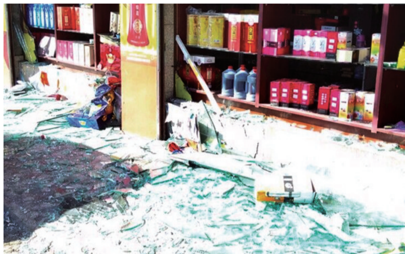
10月24日中午11点50分,颍上县鑫泰化工有限公司一合成塔高压管道发生爆炸,巨大的爆炸声导致附近居民区以及旁边的很多店铺窗户玻璃被震碎。事故还导致部分氮气和氢气泄漏,但暂不会对环境造成污染。截至记者发稿时,当地尚未接到人员伤亡报告。 巩彬 记者 杨文艺 文/图
