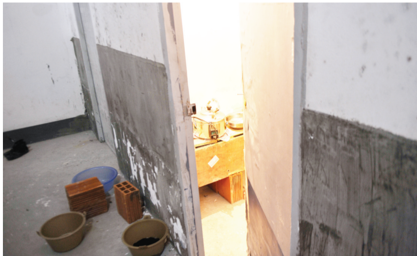
地下车库被改造住房,还有人使用电热水壶
