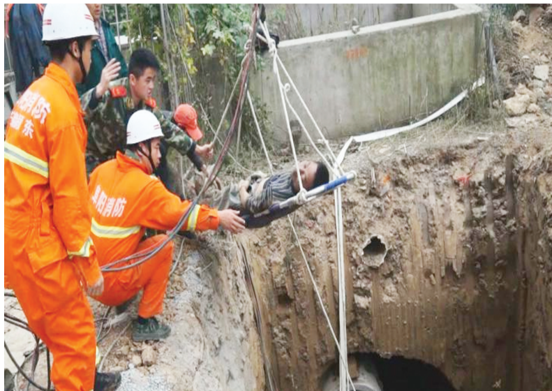
10月16日上午8点半左右,阜阳市一建筑工地正在施工管道过程中发生塌方,一名工人被困。辖区消防部门赶到事故现场时,该男子已经被3名工友徒手扒出,躺在约3米深的土坑里,120急救人员和施救工友正在对他进行心肺复苏。随后,众人将被困男子抬上担架,并利用起吊机将该男子转移到地面上,随后将其紧急送往医院。目前,受伤工人脱离了生命危险。周腾 陈瑞祥 巩彬 记者 杨文艺 文/图
