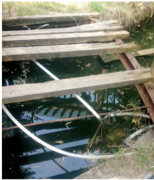
这座小桥木枕残缺不全,电线还露在水面上
