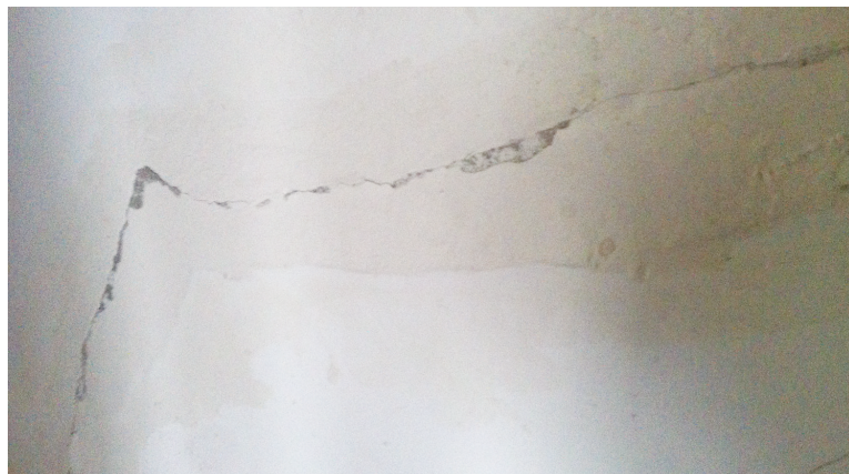
投诉者称,墙体开裂的现象在蚌埠市光彩大市场屡见不鲜
