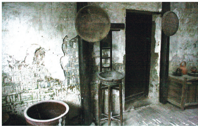
杨振宁故居内斑驳的墙壁
