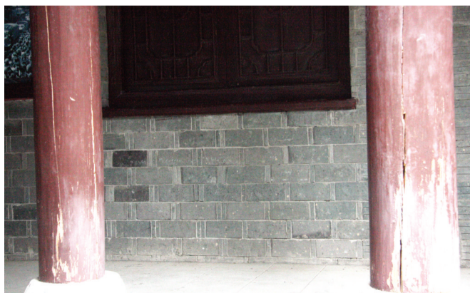
孙立人故居内的立柱有开裂
