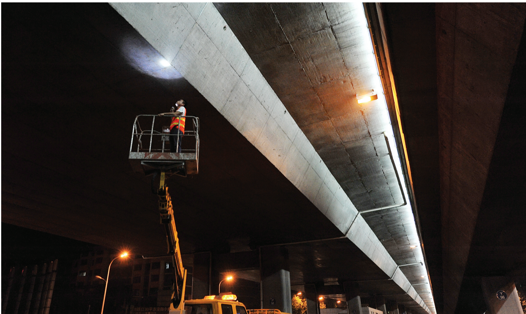
庞大的高架桥上，25岁的杨明用探照灯仔细地寻找着每一个受损点
