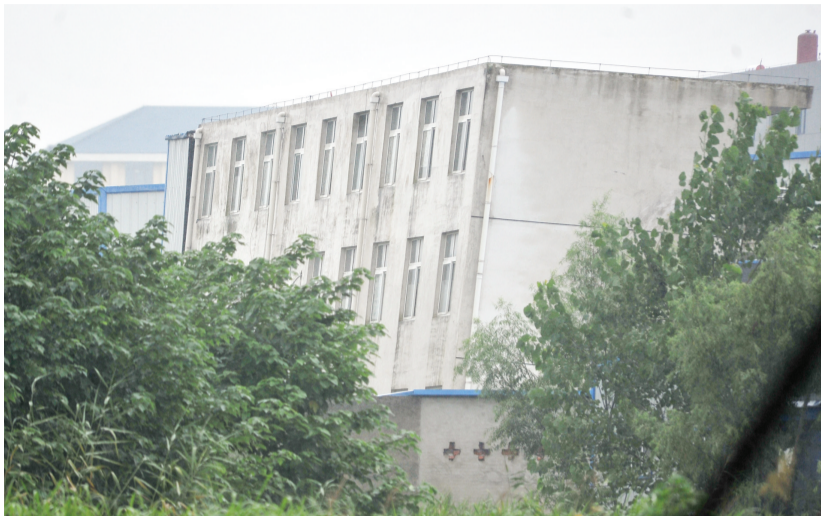
该楼倾斜大约有10度
