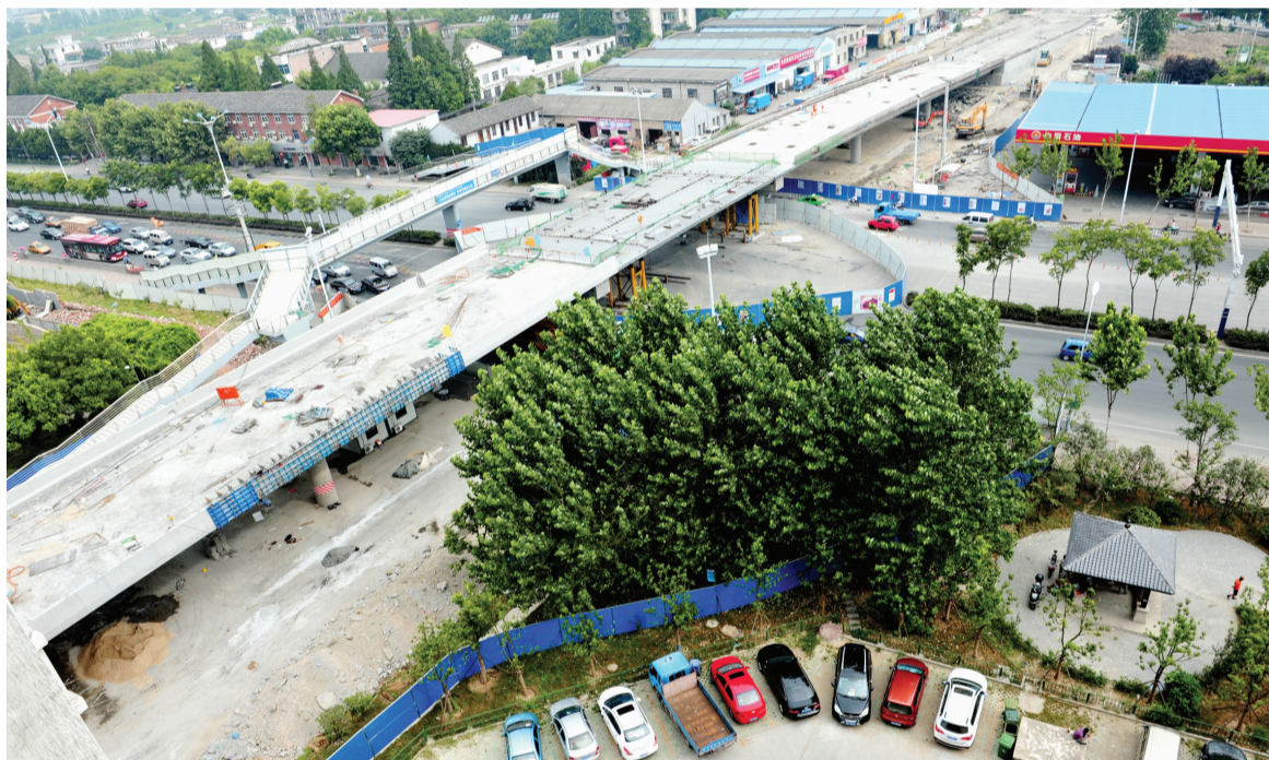
合肥桐城路上跨南二环桥日前正式合龙,记者昨日来到现场看到,工人们正在进行钢箱梁箱体的焊接,桥面铺装施工也全面展开,计划9月通车。 记者 倪路/图
