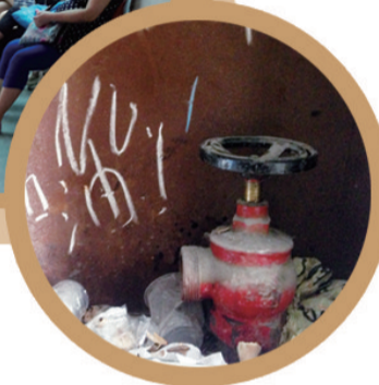
消防栓边堆满垃圾
